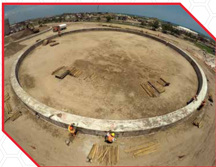
Optimización de cimentación para soporte de tanque de 26m de diámetro con anillo de cimentación de concreto reforzado.
