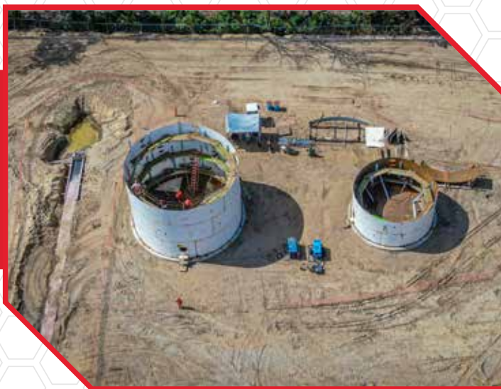
Tanques de almacenamiento de agua sobre terreno mejorado.
